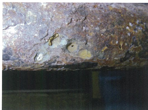
保温材内の全体腐食
