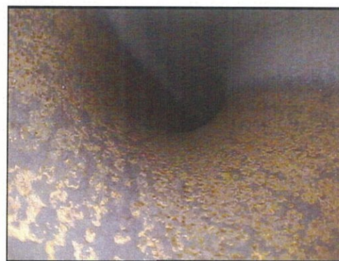
鋼管内面の腐食 (内視鏡撮影)
